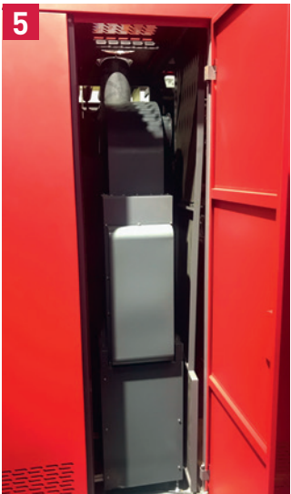
5 Комбинированная сушка водных чернил производится с помощью ИК-излучателей и обдува отпечатков горячим воздухом. Затем вытяжка отправляет горячий воздух в систему вентиляции типографии
